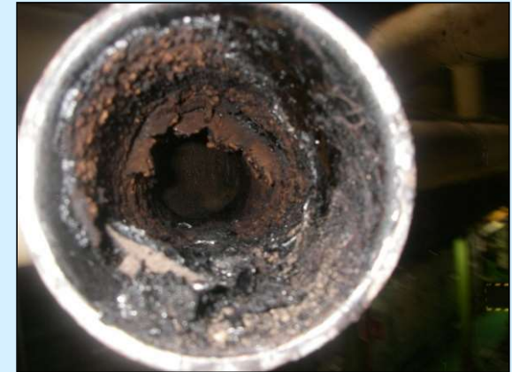
加硫炉排気ダクト
