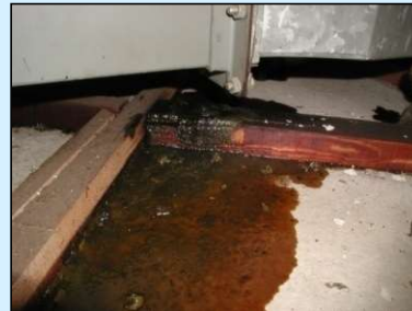
ダクト継ぎ目から流出した油汚れ
