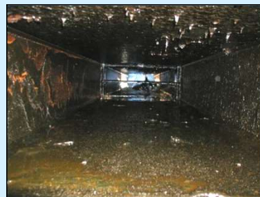
ダクト内に堆積した油汚れ
