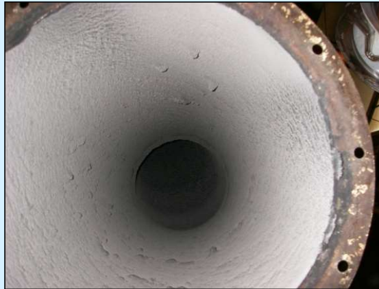
シリコン塗装ブース排気ダクト
