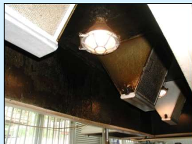
フード内壁に付着した油汚れ
