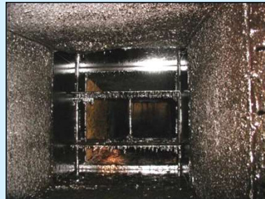
防火装置に付着した油汚れ
