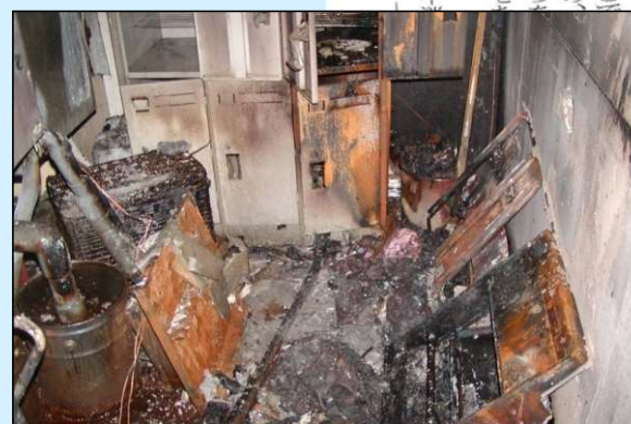
ダクト火災の現場写真
